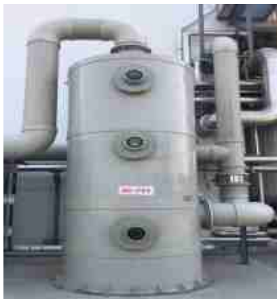
AKD及松香线填料除雾塔
