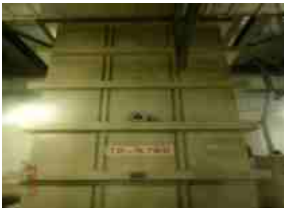
10、20、30、40线共用填料除雾器现状图
