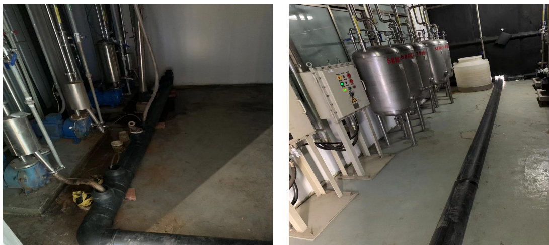
图 4.1-5 车间污水输送管线照片
