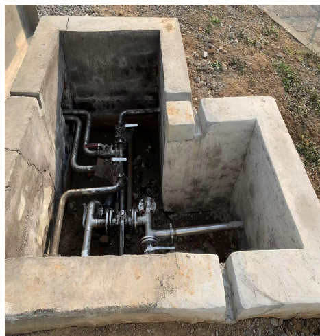
图 4.1-4 物料输送管道现场照片
