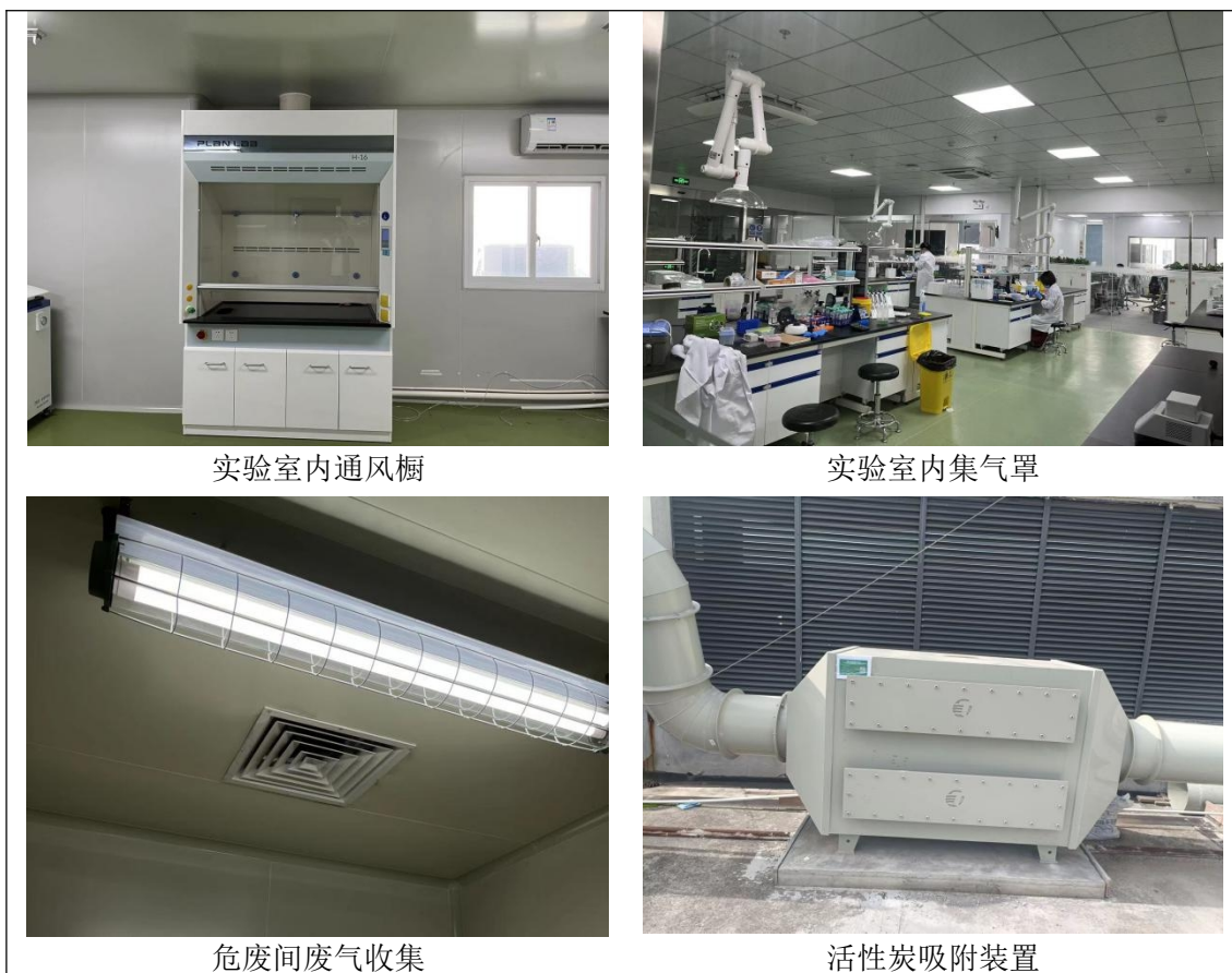
图 3-1 有组织废气收集、治理设施
