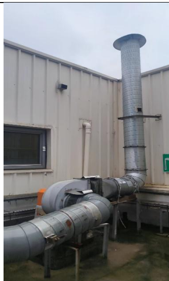
灌装车间废气排口 DA003
