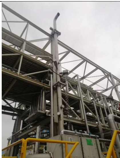
各罐区废气排口 DA002
