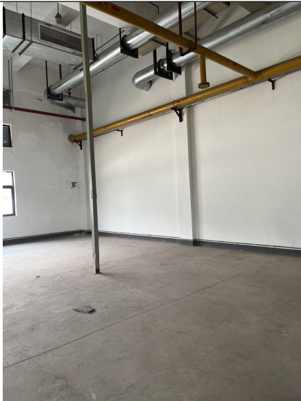
718 动力站锅炉房内现状
