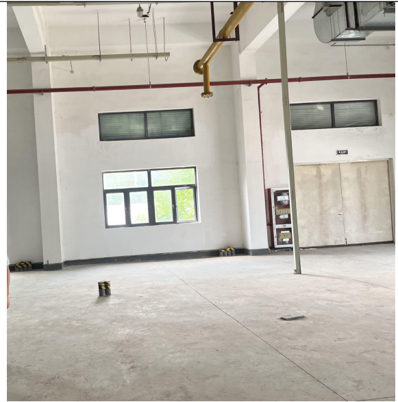
718 动力站锅炉房内现状
