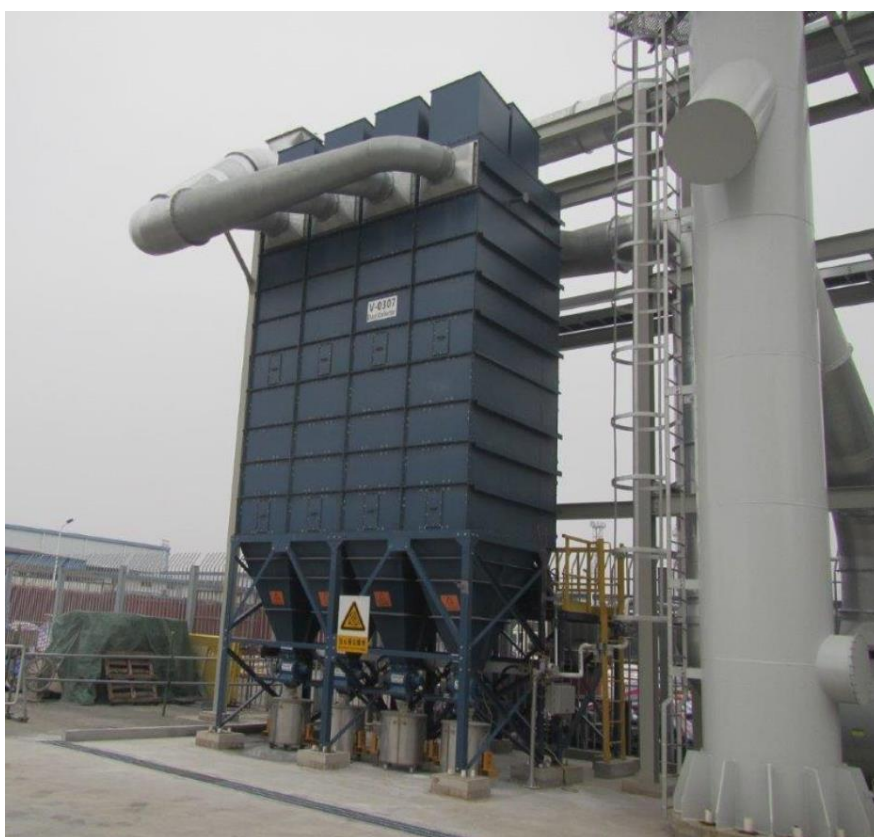
图 3-4 六号线新增袋式除尘器
