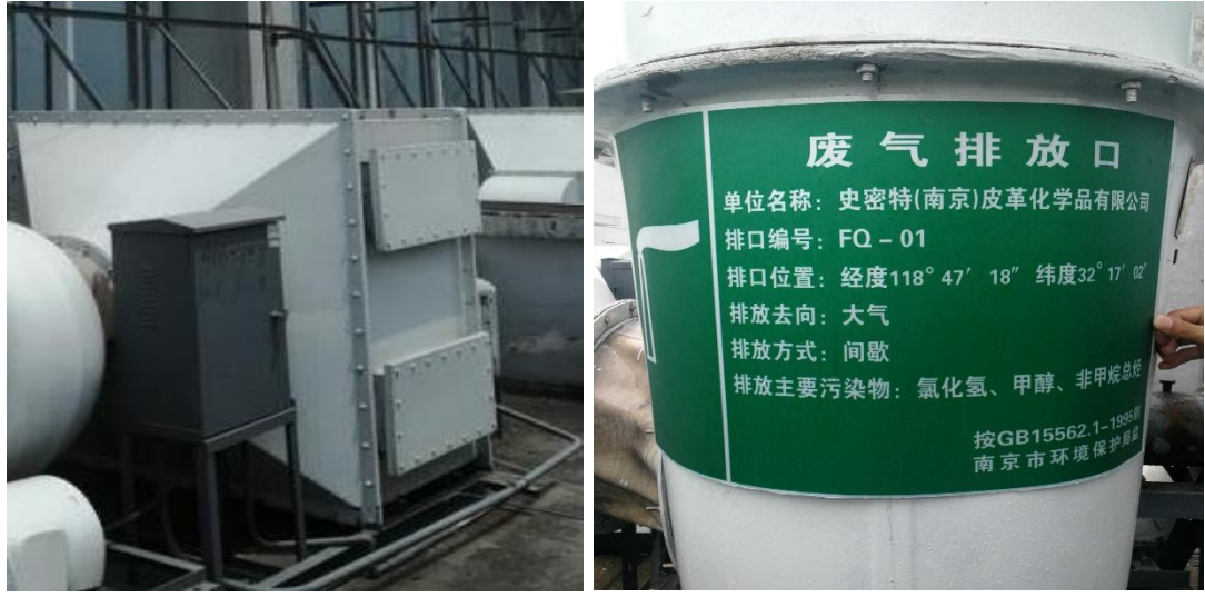
图 2-7 原有研发中心项目废气处理装置及排口标识
