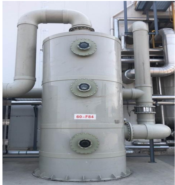
AKD 及松香线填料除雾塔
