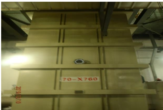
10、20、30、40 线共用填料除雾器现状图
