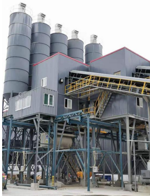
水泥料仓及搅拌站除尘设施
