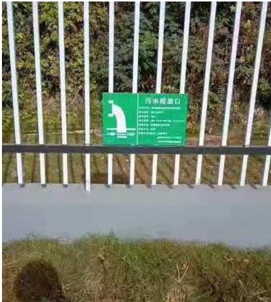
化粪池所在位置及废水排口
